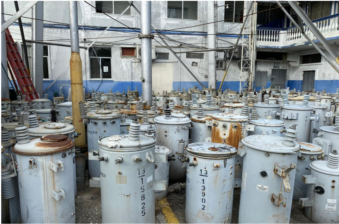
Foto 3 Zona externa (bodega de transformadores dañados) Fuente: Elaboración propia
