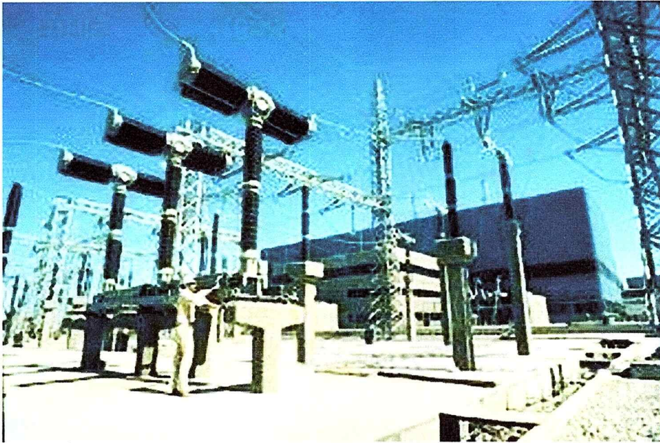
SUBESTACIÓN DE DISTRIBUCIÓN DE ENERGÍA ELÉCTRICA
